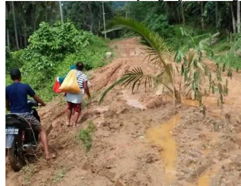
Gambar 3. Kondisi Jalan Sebelum Adanya Peningkatan Kualitas Jalan Kabupaten
